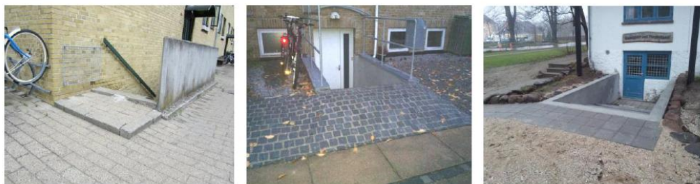
Figur 4-1: Eksempler på simpel klimasikring af kældre med hævede kanter rundt om kældernedgange. Teknologisk Institut har beskrevet dette i to rapporter, der har mange praktiske eksempler (se /7/ og /8/).
